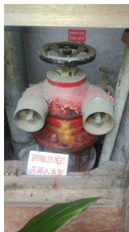
花灑入水掣(漏水,需更換)
