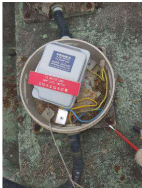
低水位(消防泵房)
