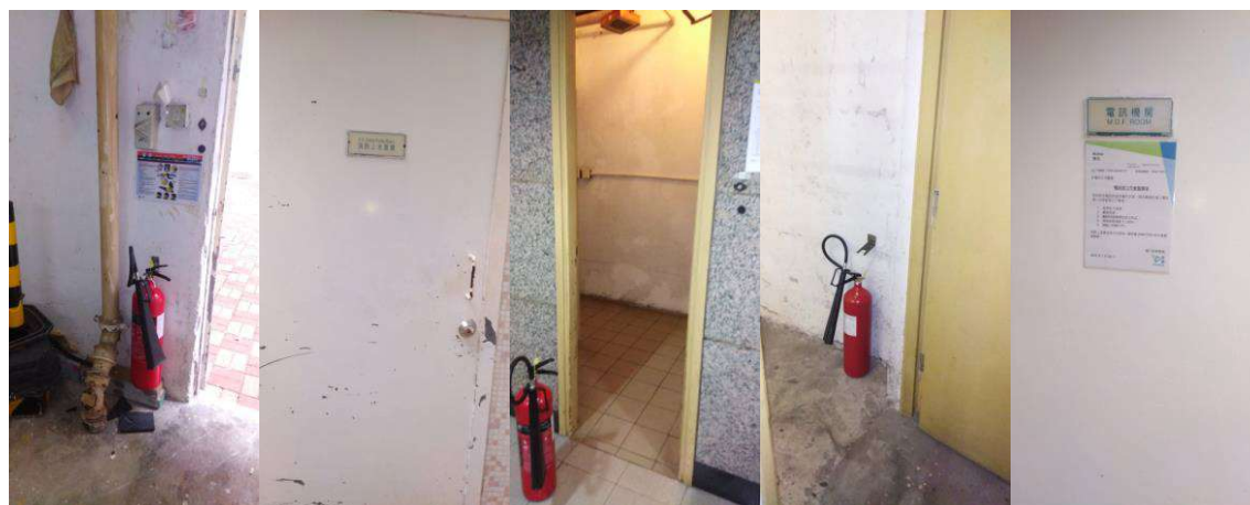
G/F 消防上水泵房,有線電視房,管理處
