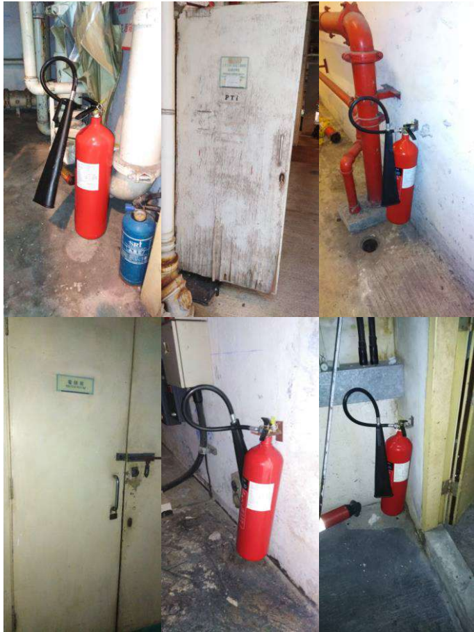
R/F 水泵房,1/F 消防上水泵房,2/F 電錶房,PTI 水泵房
