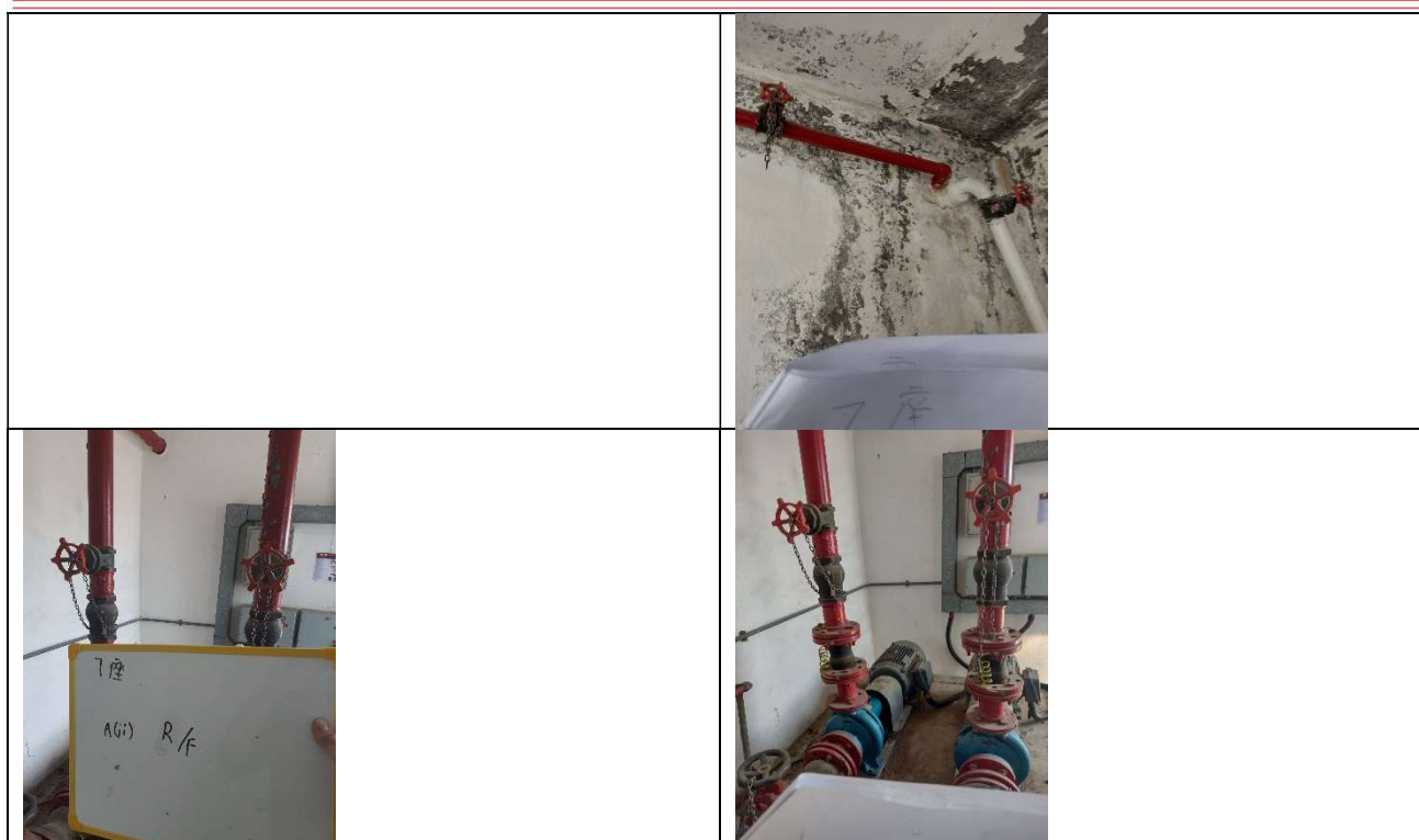
G(ii) 4.補回欠缺之消防系統閘掣「常關」牌 (2 塊)
