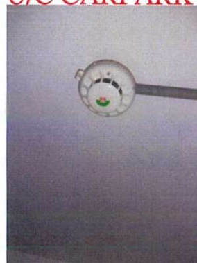
U/C CARPARK FAN D81
