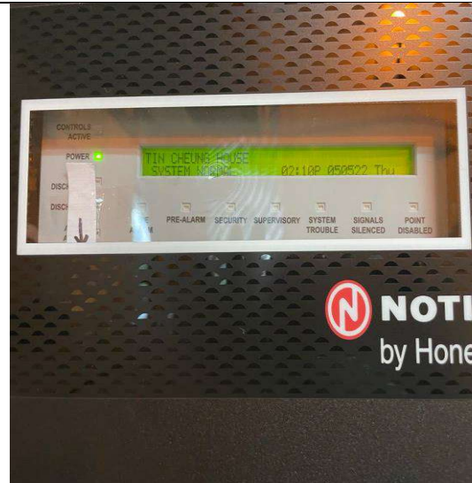
天祥樓 系統正常
