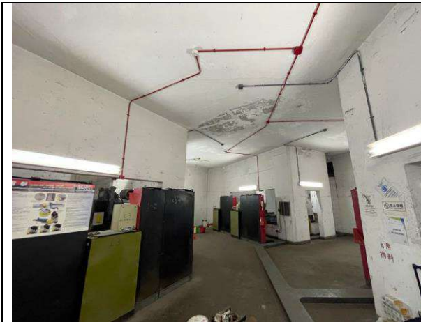
天怡樓 UR/F 電梯機房煙霧偵測器
