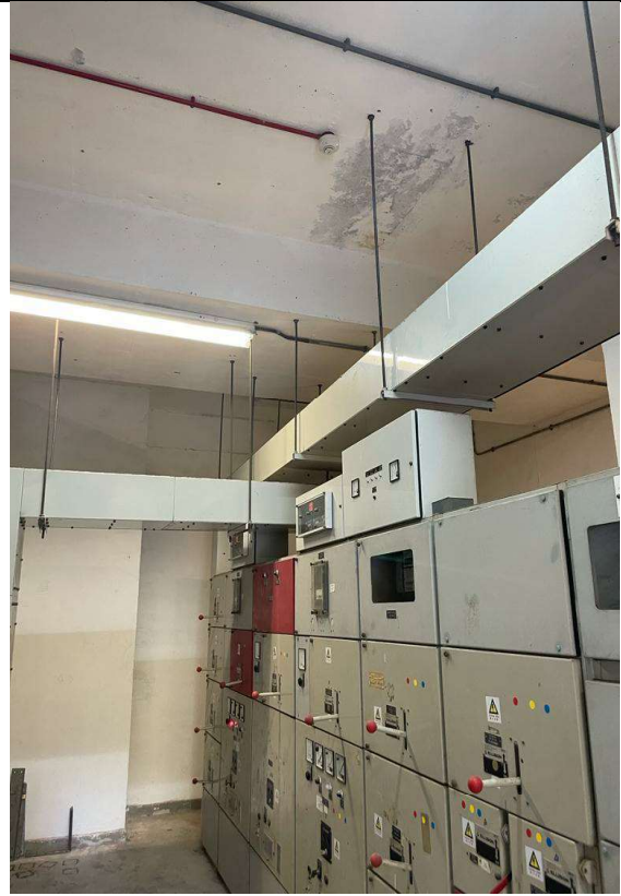
天祥樓 G/F 總電掣房 煙霧偵測器
