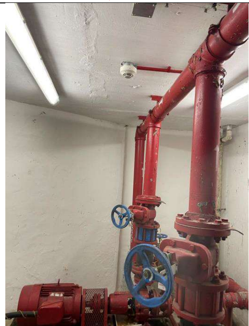
天祥樓 18/F 煙霧偵測器
