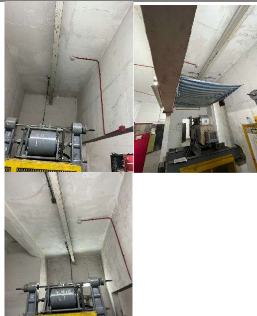
天祥樓 UR/F 電梯機房 煙霧偵測器
