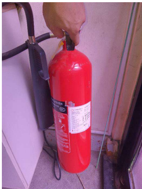
標書 23 更換 5KG CO2 滅火筒 (2座地下管理處工程部)
