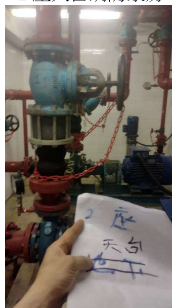
標書 18 安裝消防閘掣掛鎖連標籤 (2 座天台消防泵房)
