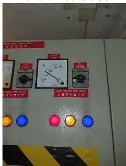
標書 17 更換消防泵控制箱之電壓 錶 (2 座天台消防泵房)
