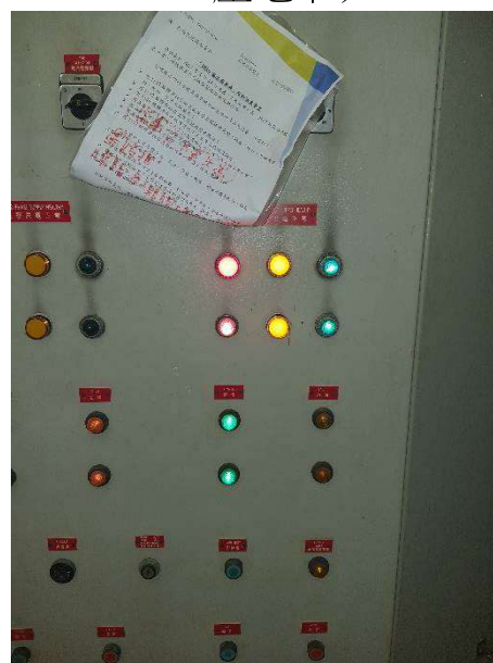
標書 14 更換街龍頭泵控制箱指示燈 (1座地下)
