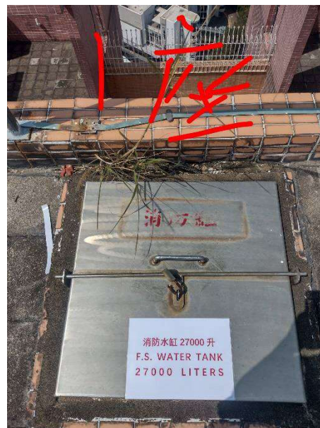
標書 8 供應連安裝消防水缸容量牌 (1座天台)
