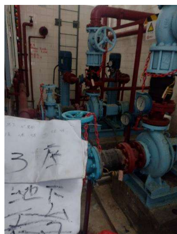
標書 33 安裝消防上水泵及中途泵 閘掣掛鎖連標籤 (3 座地下消防上水泵房)
