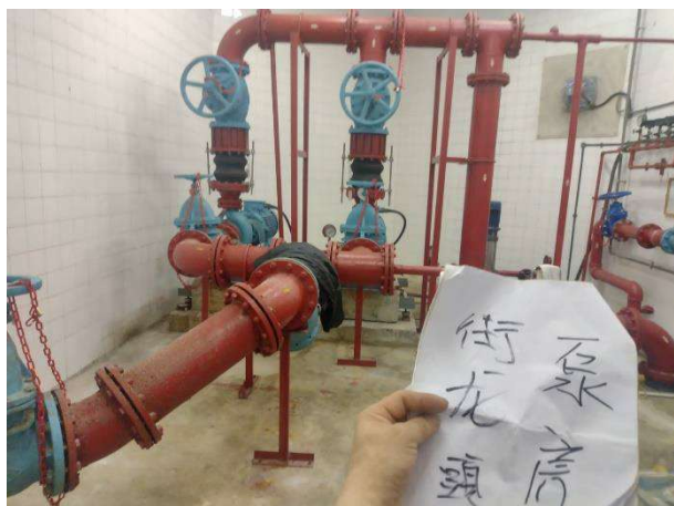
標書 13 安裝街龍頭泵閘掣掛鎖連標籤 (1座地下)
