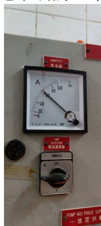
標書 30 更換消防上水泵控制箱之電流錶 (3 座地下消防上水泵房)
