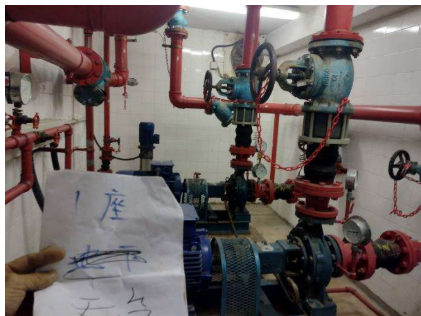
標書 7 安裝消防泵閘掣掛鎖連標籤 (1座天台消防泵房)
