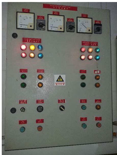
標書 31 更換消防中途泵控制箱指示燈 (3 座)
